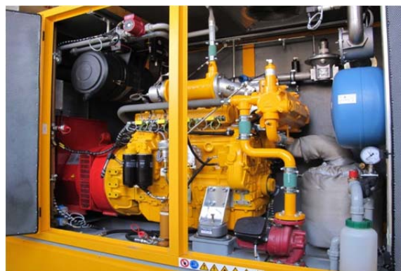
Abb. 1: neu installiertes Blockheizkraftwerk
